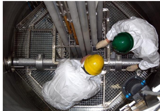
Práce uvnitř reaktorové nádoby
