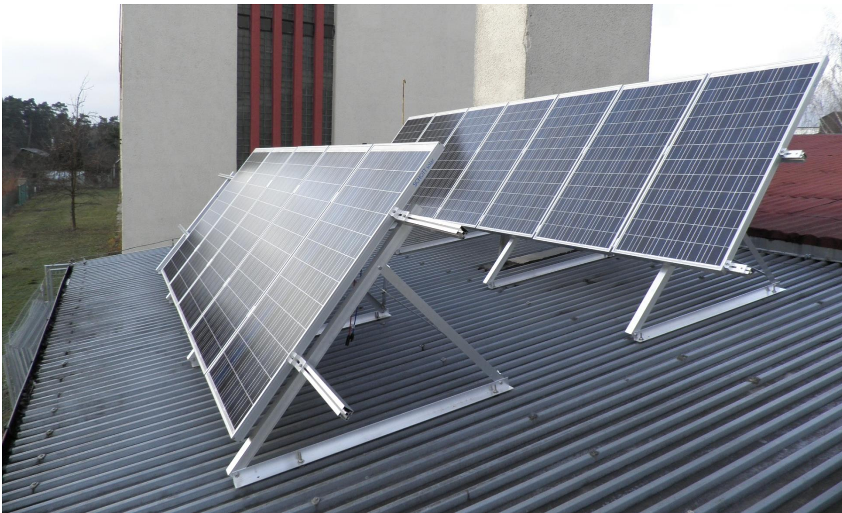
Solární fotovoltaický systém Laboratoře palivových článků.
