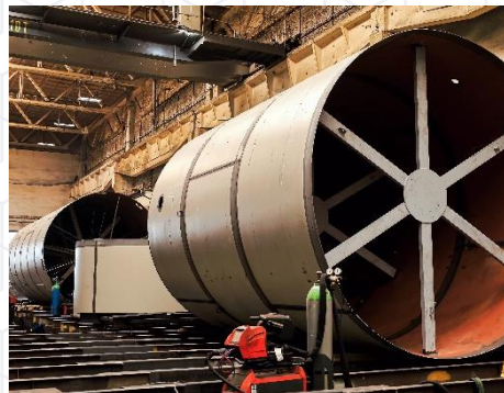
Kalící nádrže Pro-Filtr Brno – Žďas a.s.
